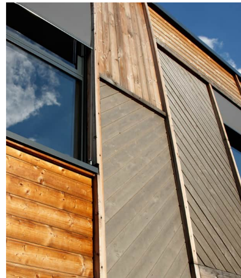
Bardage façade, panaché de 4 essences de bois de récupération.
